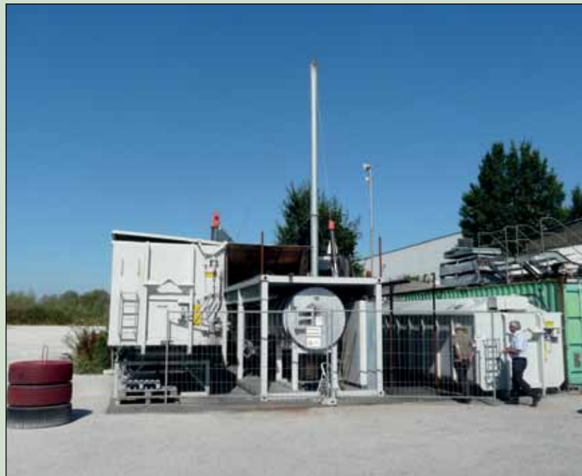
Der Container mit dem zu verkohlenden Material ist links, der Behälter mit der Biokohle rechts im Bild. Dazwischen die Pyreg-Karbonisierungsanlage.
